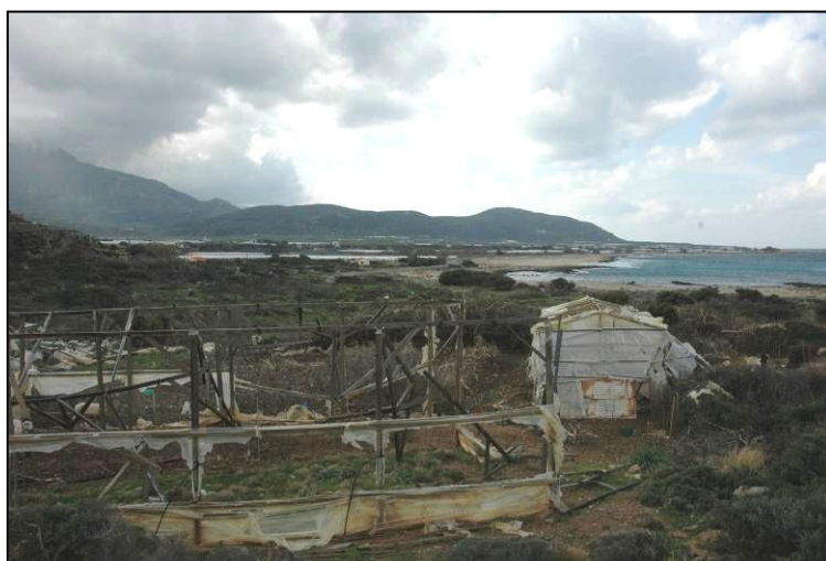
Εικόνα 53. Εγκαταλελειμμένες θερμοκηπιακές εγκαταστάσεις εντός του οικοτόπου 2250* στην περιοχή Φαλάσσαρνα.
